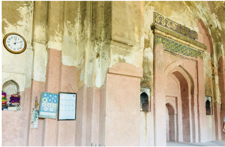
चित्र 14: खैर- उल- मनाज़िल मस्जिद की स्थिति Figure14: Condition of Khair-ul-Manazil Masjid
